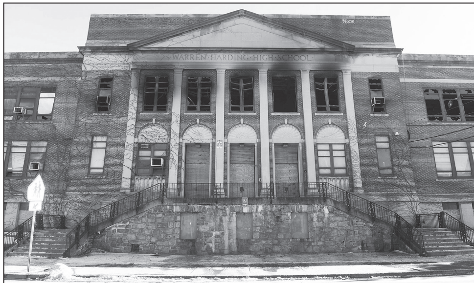
Daños ocasionados por incendio en el antiguo edificio de la escuela secundaria Harding en Bridgeport, enero de 2024. Ned Gerard/Hearst Connecticut Media
